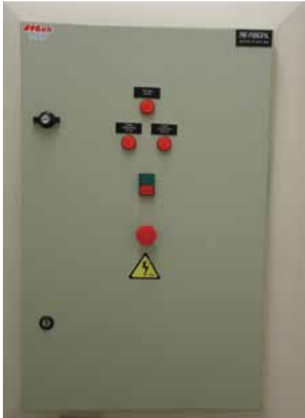
Na inspeção realizada no AME, verificou-se que o quadro elétrico estava localizado no ponto correto e que seus componentes estavam dispostos de maneira adequada.
